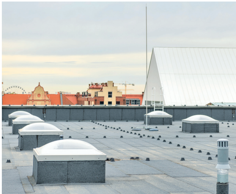
Fig. 9 – Lanternneaux d'éclairage mcr PROLIGHT
