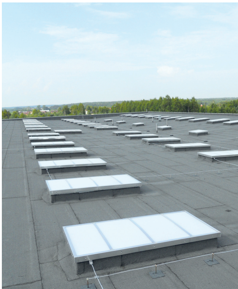
Fig. 10 – Lanternneaux d'éclairage mcr PROLIGHT
